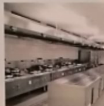
中央厨房系统
